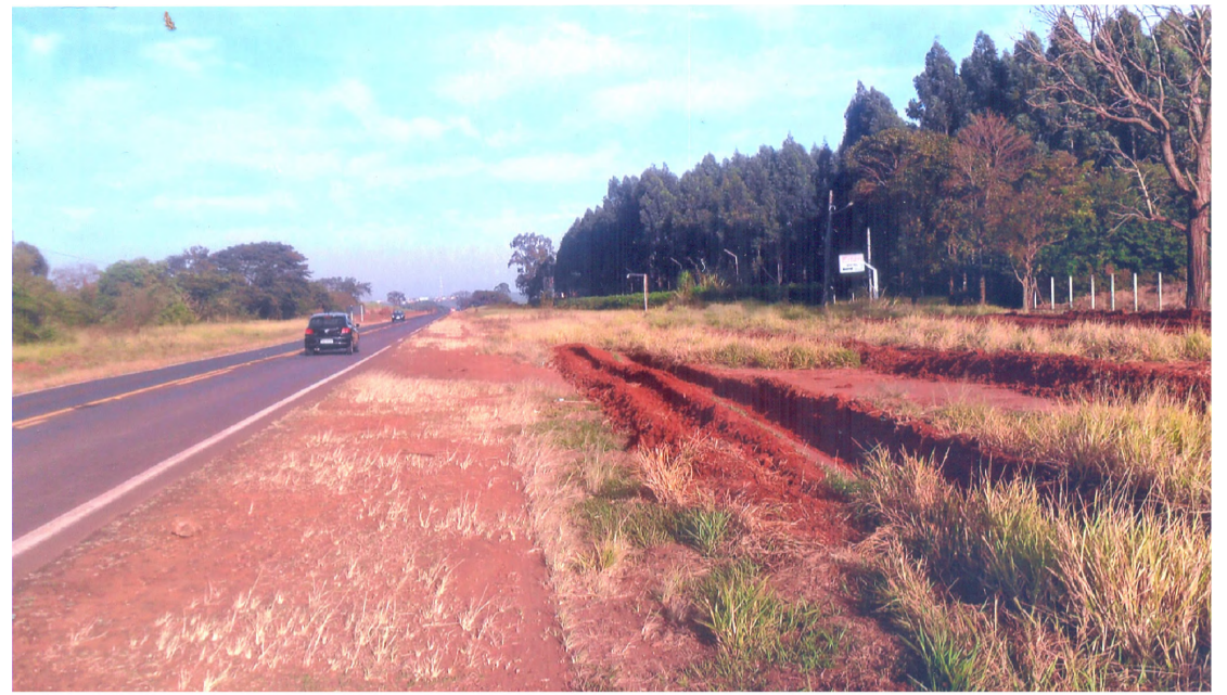
Valetas feitas pelo DER em terreno às margens da rodovia Osny Matheus geram reclamações
