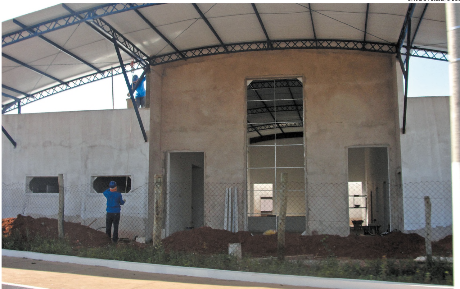
Em construção na Vila Honorina, nova unidade de saúde terá 1,2 mil metros quadrados de área construída e vai custar R$ 1,5 milhão
