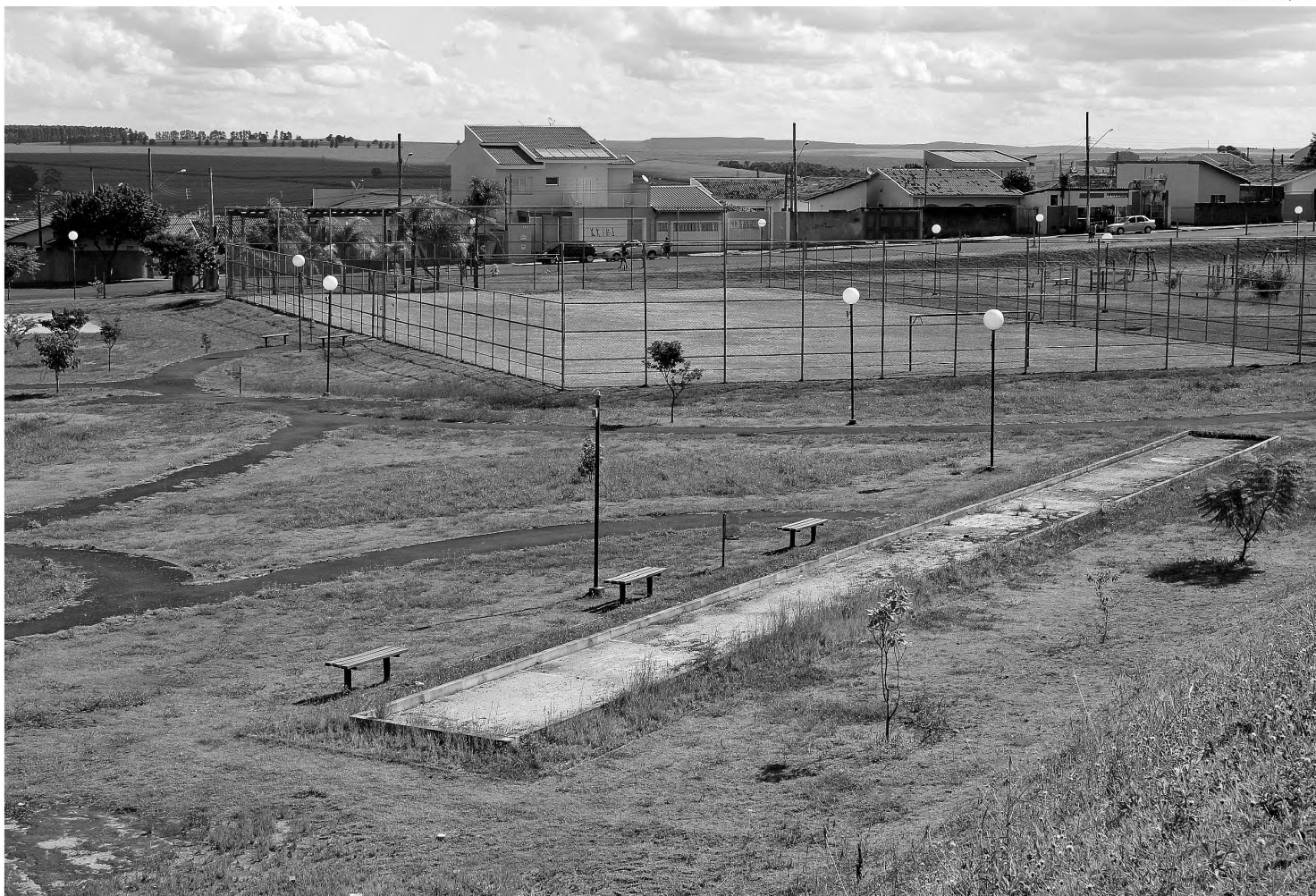
FUTURO GINÁSIO – Local vai receber obras do futuro ginásio com quadra de medidas oficiais
