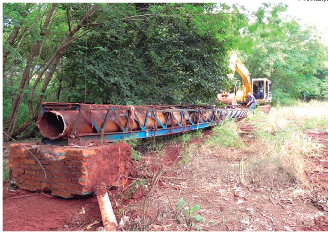
RECUPERAÇÃO - Servidores do Saae durante trabalho em um dos 8 pontos rompidos na inundação de janeiro
