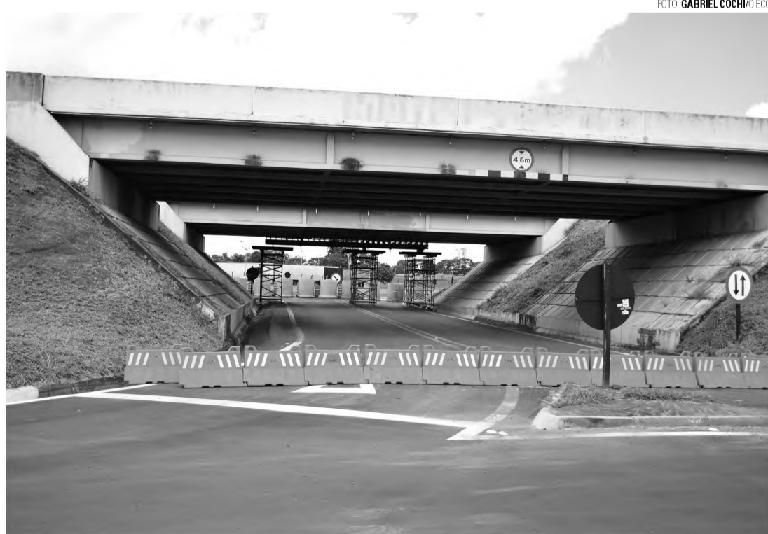
ESPERA - Obras no viaduto do Distrito foram iniciadas, mas não têm prazo para conclusão
