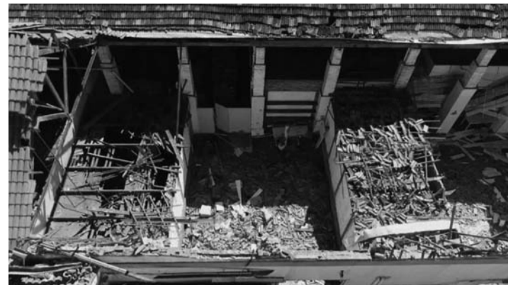
TUDO NOVO - Após demolição, prédio da creche Diomira Paschoal dará lugar a outra creche escola
