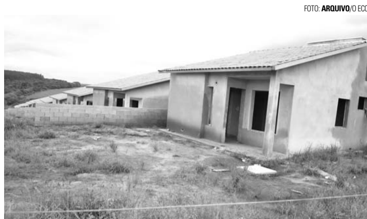
ABANDONO - Obras estão paralisadas há quase um ano e meio, desde outubro de 2016
