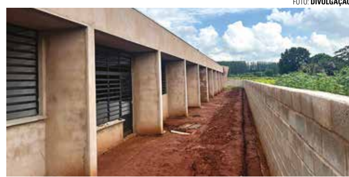
OBRAS - Creche-escola está em construção no Conjunto Habitacional Governador Mário Covas; terreno tem cerca de 2,8 mil metros quadrados,
