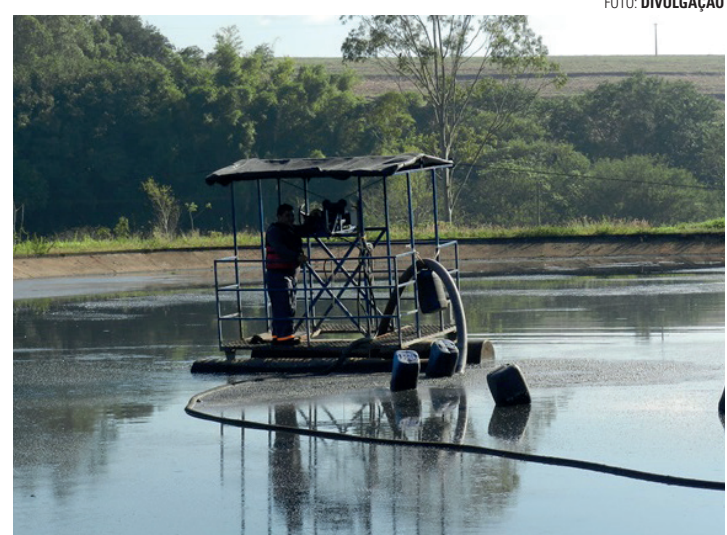
MELHORIAS - Ampliação da capacidade de tratamento de esgotos é um dos focos da primeira etapa do projeto; na foto, registro da lagoa da ETE
